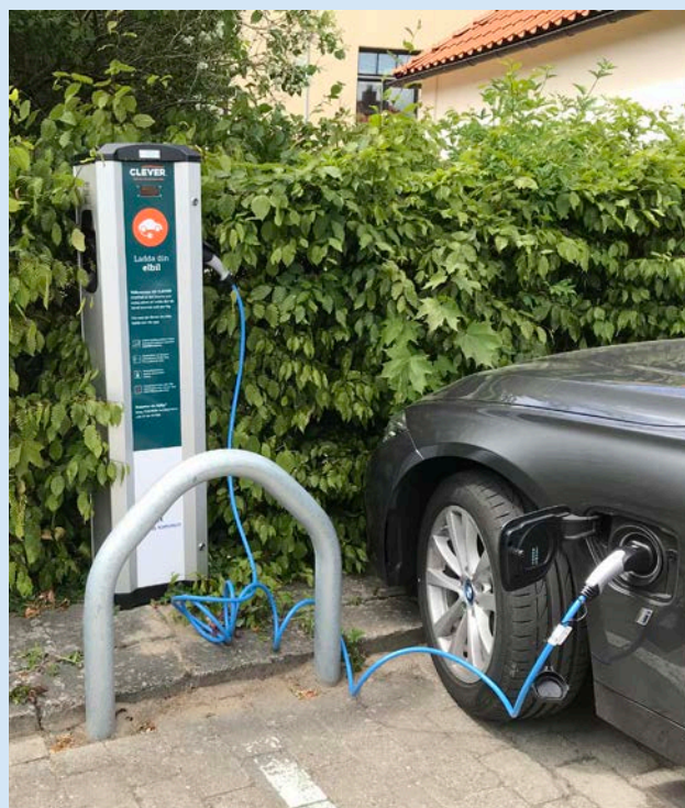
Laddstolpe för elbilar i Ystad. Foto: Emma Holgersson
