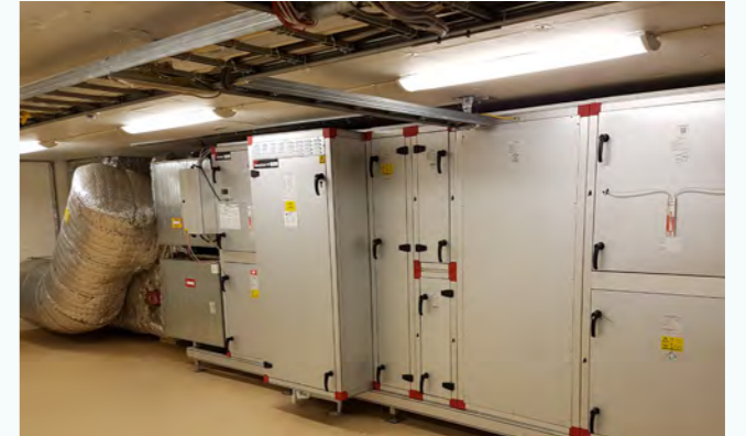
Nytt ventilationsaggregat på Bellevue.
