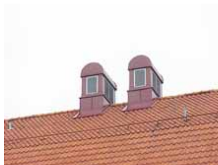
BRUZELIUS 2 A från SO VENTILATION
