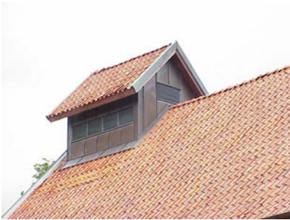
RISSELMAGASINET från SV VENTILATION
