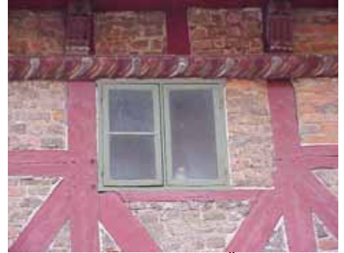
WALDEMAR 6 A från V FÖNSTER
